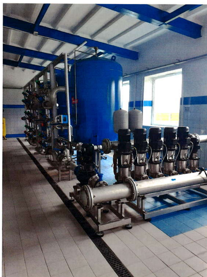
Zdjęcie 4. Urządzenia uzdatniania wody w Naramicach.
